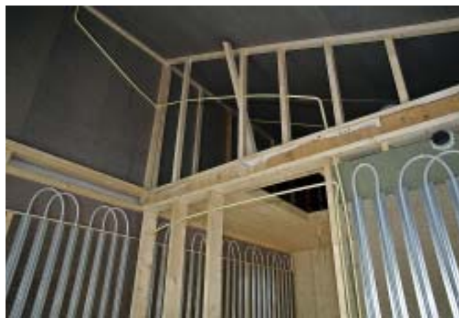
Een deel van de buitenmuren heeft wandverwarming.
