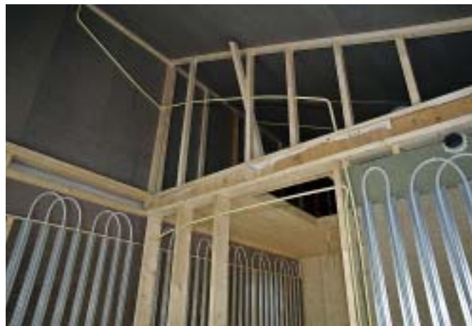
Een deel van de buitenmuren heeft wandverwarming.
